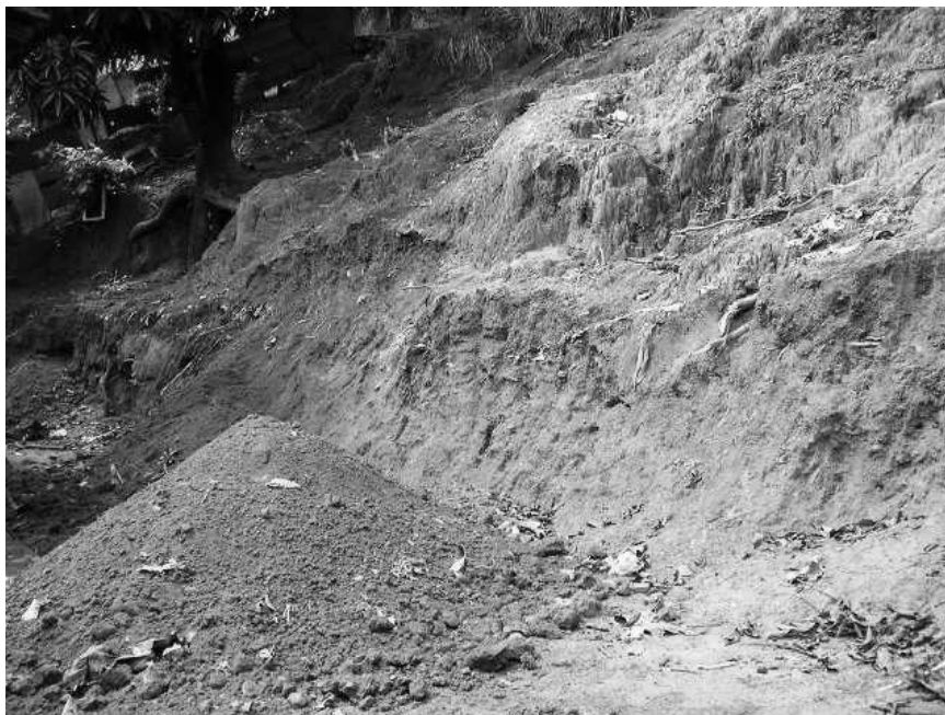
Figura 21 – Constantemente os moradores da favela São José degradam as encostas, construindo aos poucos grandes taludes a partir da prática da retirada da argila (barro) para a construção das moradias, desencadeando, no futuro, deslizamento de terra. Foto: Jocélio Araújo dos Santos, janeiro de 2004.
