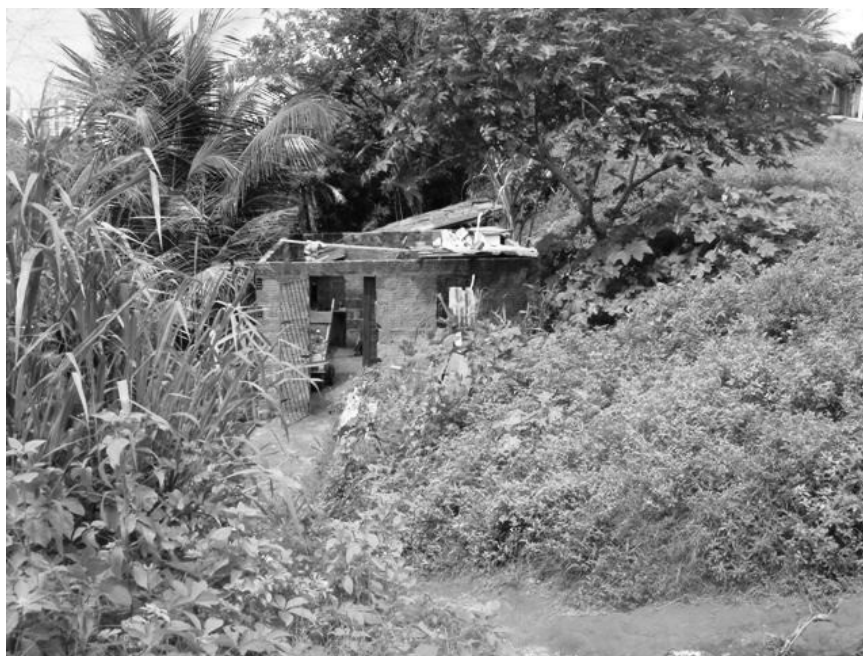
Figura 51 – Casa construída em alvenaria sobre um talude de corte próxima ao topo da encosta. Foto: Jocélio Araújo dos Santos, fevereiro de 2007.
