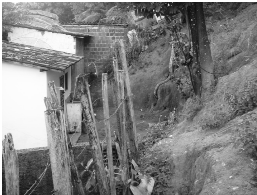
Figura 16 – Favela São José ocupação em meia encosta, área de risco de deslizamentos de encosta para mais de 600 famílias. Foto: Jocélio Araújo dos Santos, fevereiro de 2007.
