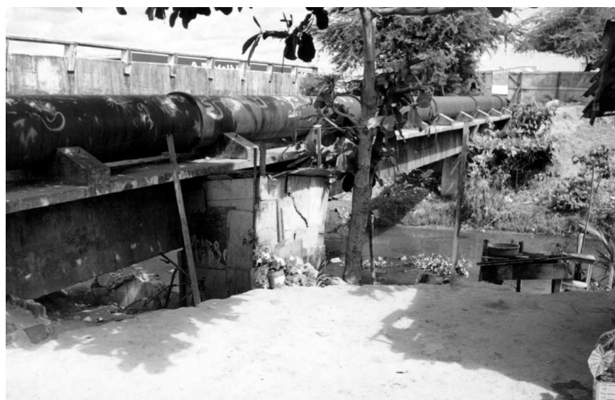
Figura 17 – Favela Beira do Cano, Bairro Padre Zé, área de risco da Cidade de João Pessoa por abrigar, aproximadamente 600 famílias próximas à tubulação de esgoto e ao mangue. Foto: Secretaria de Desenvolvimento Social.
