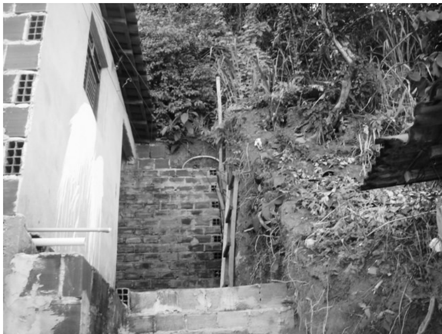
Figura 47 – Aos poucos as encostas vão dando lugar as moradias. Casa construída em cima de um talude de corte revestido em alvenaria. Foto: Jocélio Araújo dos Santos, fevereiro de 2007.
