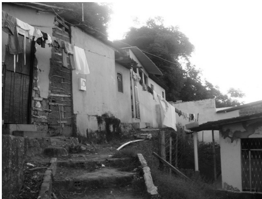
Figura 49 – Casa construída em taipa sobre um talude de corte próximo ao topo da encosta. Foto: Jocélio Araújo dos Santos, fevereiro de 2007.
