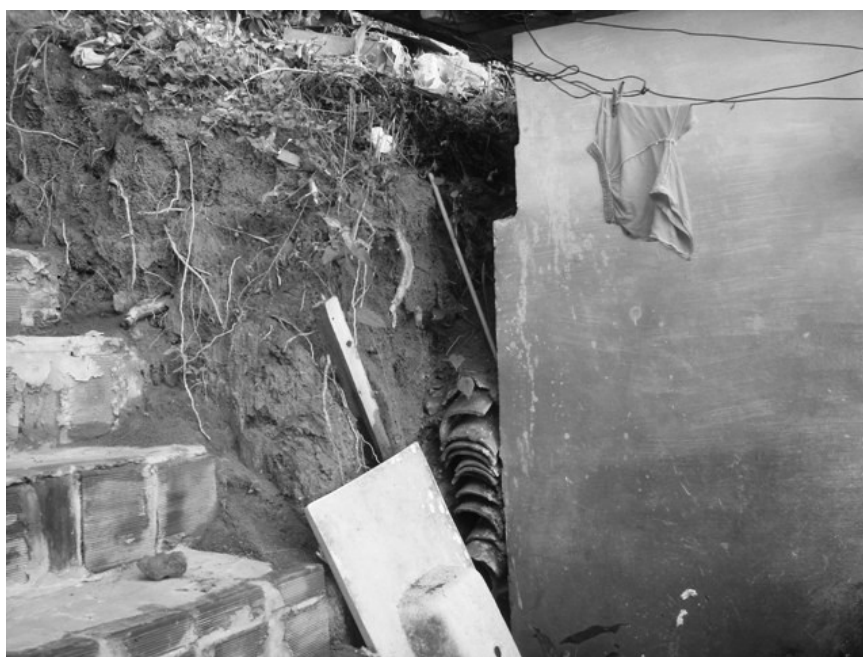
Figura 48 – Corte em ângulo reto possibilitando a construção da moradia. Chamamos atenção para a escadaria construída para dar acesso à casa da Figura 47. Foto: Jocélio Araújo dos Santos, fevereiro de 2007.
