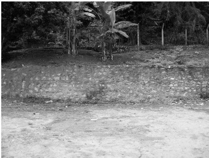
Figura 29 – Muro de arrimo na favela São José. Medida estrutural na prevenção de deslizamento. Foto: Jocélio Araújo dos Santos, fevereiro de 2007.
