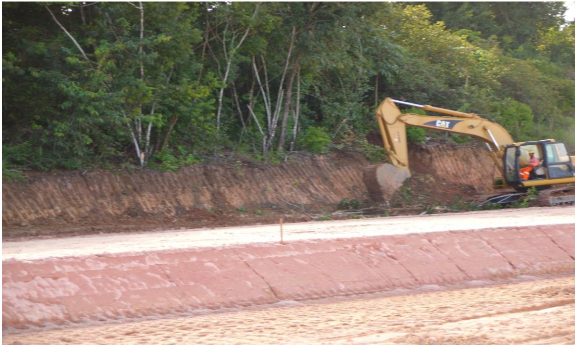
Figura 15: Retirada da Mata e terraplenagem para expansão do CIPS em sua área central Foto: Enildo Gouveia Outubro/2008
