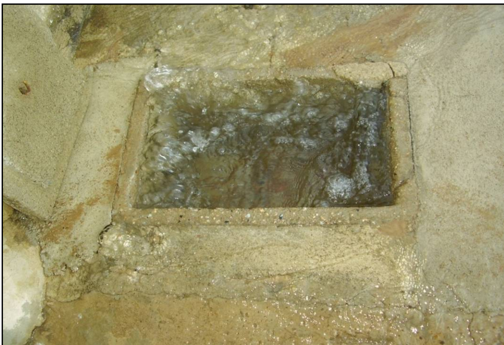
Figura 61 – Vazamento na caixa de hidrômetro na rua Salustiano Bezerra Cabral, n° 60, Cruzeiro – Campina Grande. (Franklyn, 04/01/2008)
