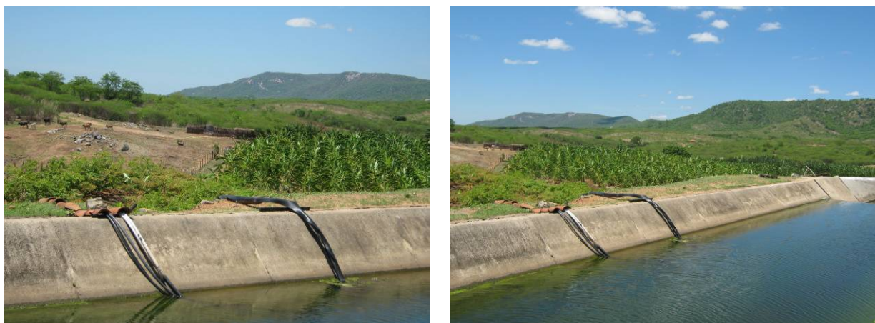
Foto 36: Captação a - primeira grande captação de água para irrigação de banana e desedentação animal;
