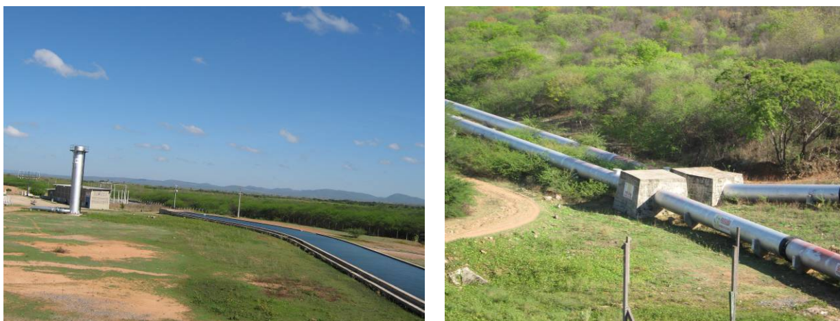
Foto 45: Captação j – estação elevatória.
