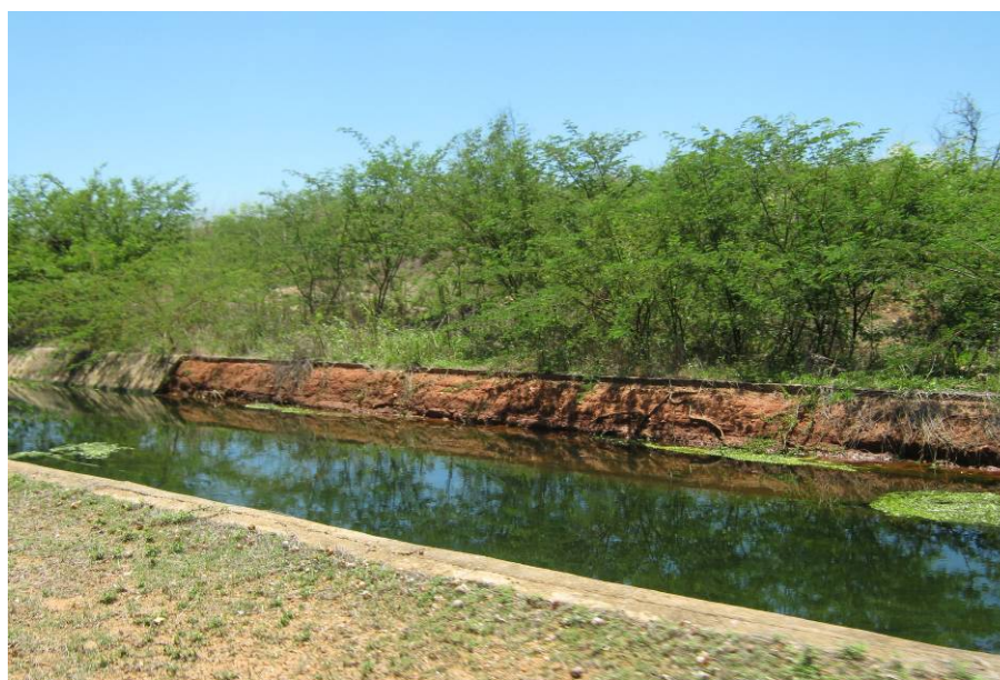
Foto 30: Trecho do Canal da Redenção danificado e sem placas de concreto na lateral. Fonte: Valéria R. P. de Lima. Janeiro de 2009.
