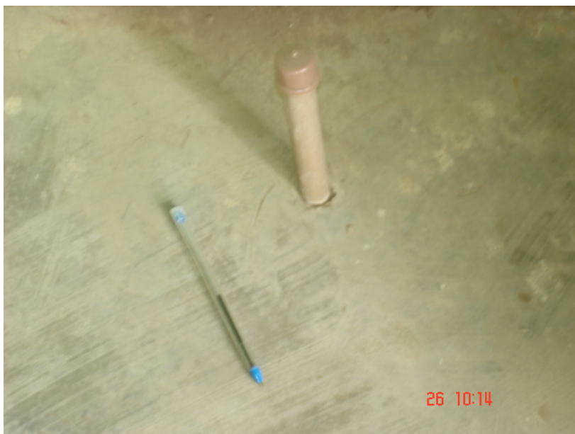
Figura 45 – Tubulação da CAGEPA cortada pelo morador. Autoria: Avaní Torres, novembro de 2006.
